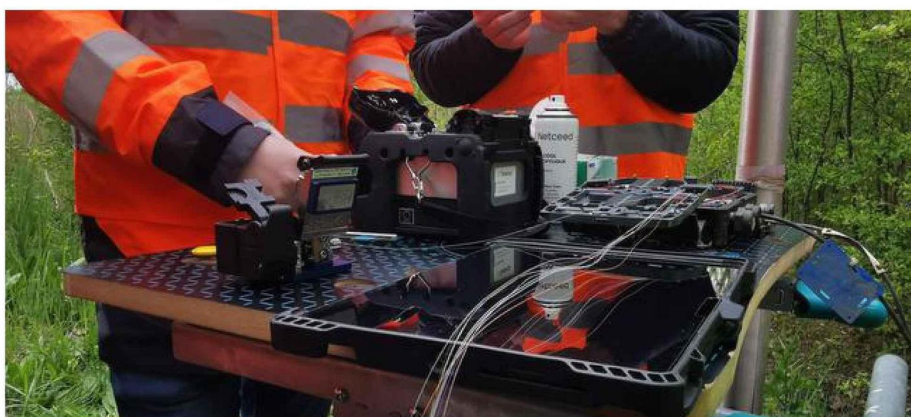
Altitude Infra, qui participe au déploiement de la fibre en Haute-Savoie, rénove déjà une partie du réseau.
